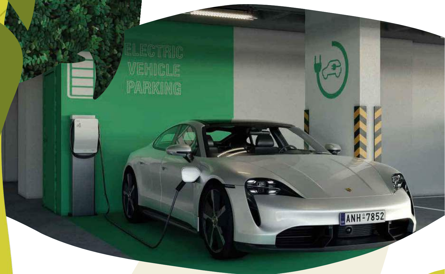
Ponto individualizado para carro elétrico na garagem
